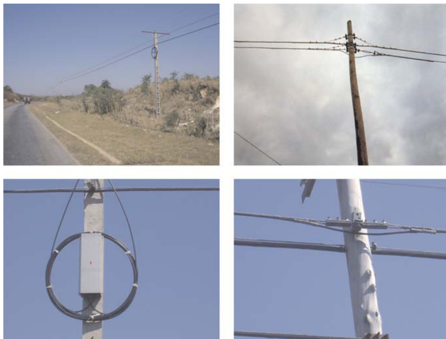
Figura 10 Ejemplos de instalaciones aéreas, devanadas y autoportante —arriba a la derecha—
